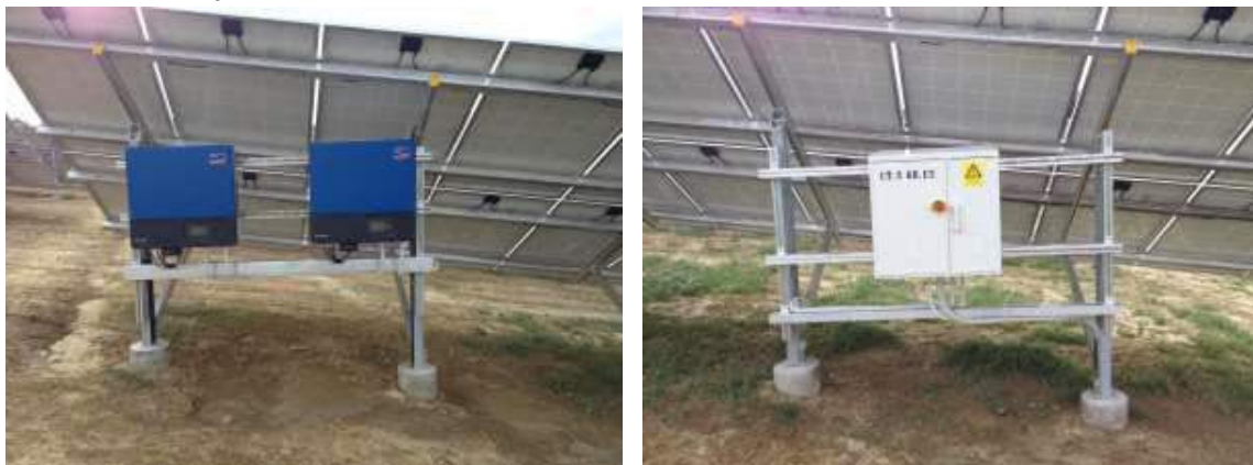
Slika 6, Slika 7: Pretvarači i SPMO ormar elektrane GR.E3
